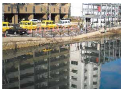
【写真5】老朽化護岸の崩壊
