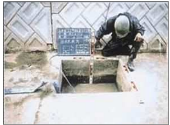
写真-4.8 防災用取水ピットの事例
