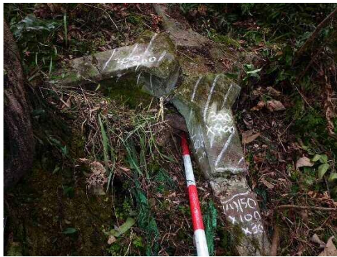
法枠工の浮き
