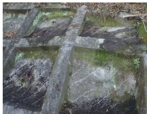
背面空洞の様子
