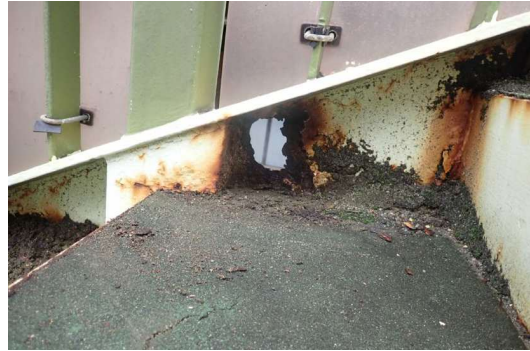
階段部主桁の腐食
