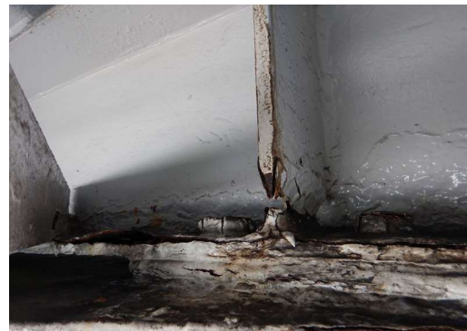
横桁部の腐食
