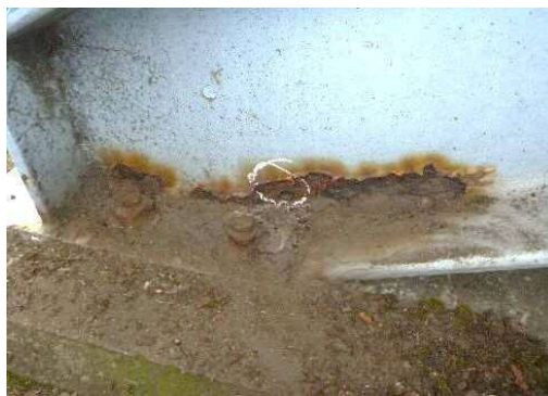
階段部主桁の腐食
