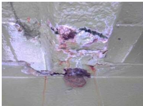
横桁、床板の腐食
