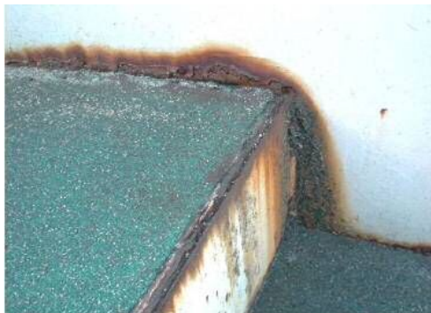
階段部の腐食
