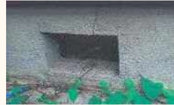
※倒壊の危険性があると判断される状態の例 (基礎のひび割れ)
