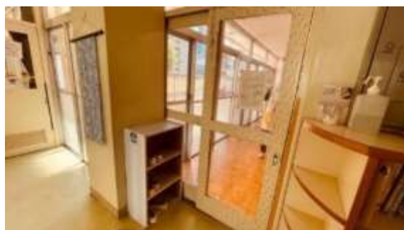
2階廊下飛び出し防止扉
