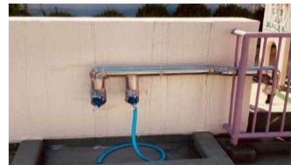
屋上遊園水道
