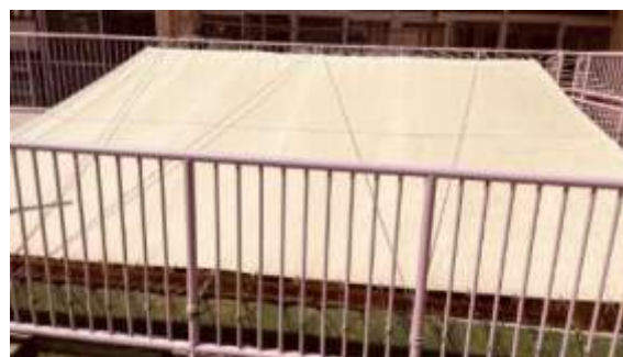
テラス転落防止対策兼雨よけ
