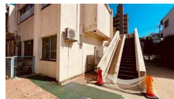
運動場屋外階段侵入防止ネット
