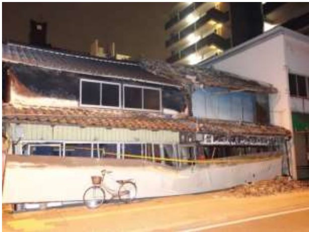
○熊本市中央区にある倒壊寸前の古民家（4月20日）
