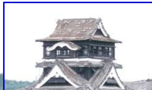
瓦が落下した天守
