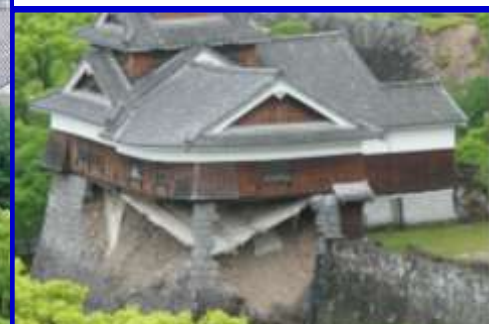
五階櫓の石垣崩壊と床の落下
