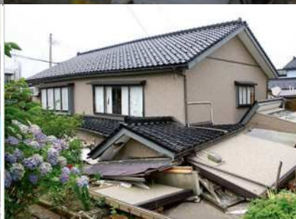
全壊 損害割合 50%以上
