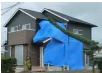
一部損壊 損害割合 20%未満
