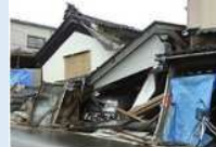
住宅被害の一例
