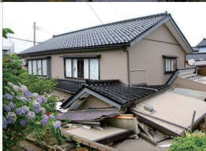
全壊 損害割合 50%以上
