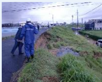
八田川堤防斜面の崩壊
