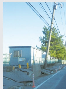
千葉県内で発生した液状化による電柱の傾きと歩道の被害
