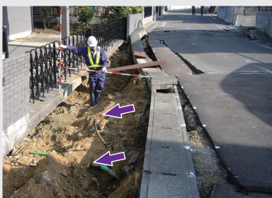
地震動で矢印方向にずれた仙台市内の宅地（盛土造成地）
