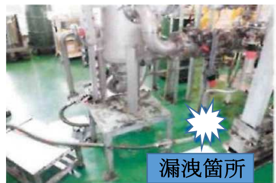
↑ 漏洩のあった一般取扱所
