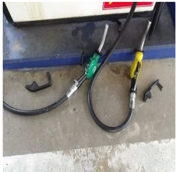
↑ 破損したノズル
