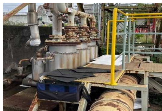
↑ 危険物の漏洩があった水封槽
