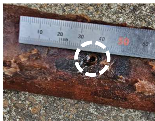
↑ 配管腐食部分
