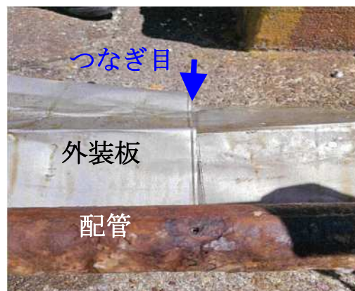
↑ 保温措置部と配管
