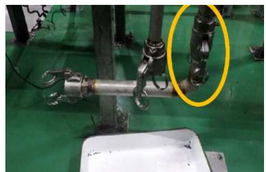
↑ カプラ接続部
