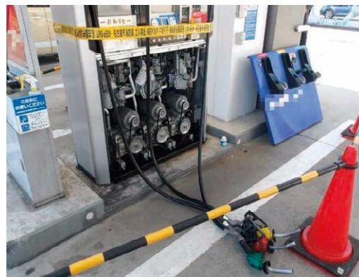
↑ 計量機破損状況
