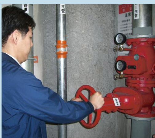
③消火を確認したら該当する制御弁を閉める（右回転）
