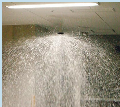
②自動的に専用ポンプが起動し、泡ヘッドから泡が放射され消火が行われる
