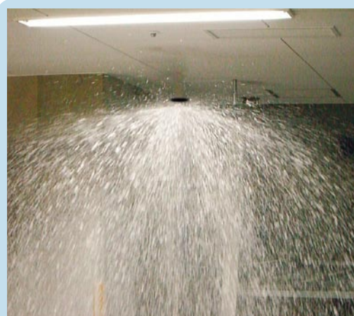
④専用ポンプが起動し、泡ヘッドから泡が放射され消火が行われる
