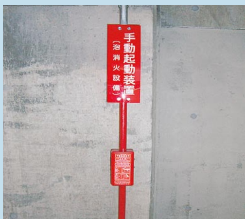
①火災が起きている区画の手動起動装置の場所へ行きます
