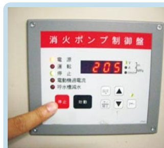
⑦ポンプ制御盤（ポンプ室等）の停止操作を行う
