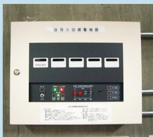
④警報盤（ポンプ室等）の復旧操作を行う
