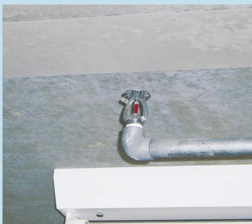
①天井に設置された感知ヘッドが熱を感知する
