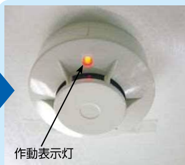
②表示区域内の感知器を確認し作動表示灯が点灯しているものを捜す
