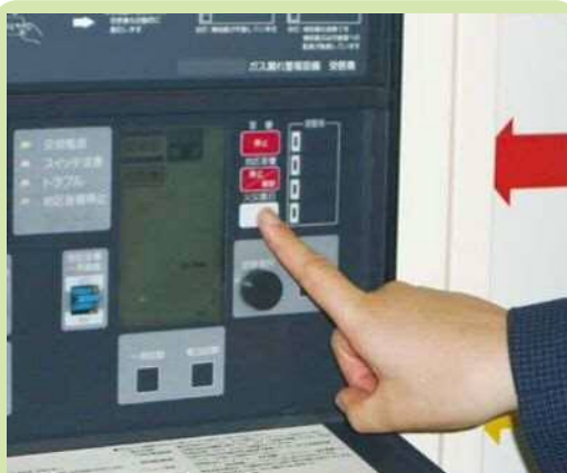
③ 自動火災報知設備の受信機で復旧 操作を行う
