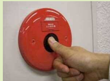
⑥ ポンプ起動ボタンを押し、赤色表示灯の点滅等で、ポンプ起動を確認する
