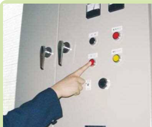
④ ポンプ制御盤(ポンプ室等)の 停止操作を行う
