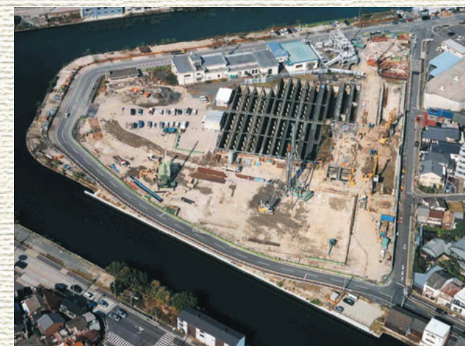
高度処理の導入を進めている露橋下水処理場
