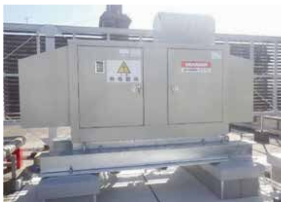
非常用発電機を屋上に設置（港消防署）
