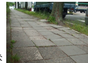
根上りの状況(修繕前)
