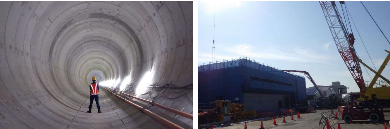
図-1 名古屋中央雨水調整池（写真左）と広川ポンプ所（写真右）
