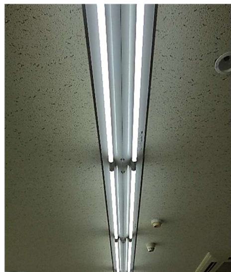
写真4 LED照明の導入 （港区他） 電気使用量の削減
