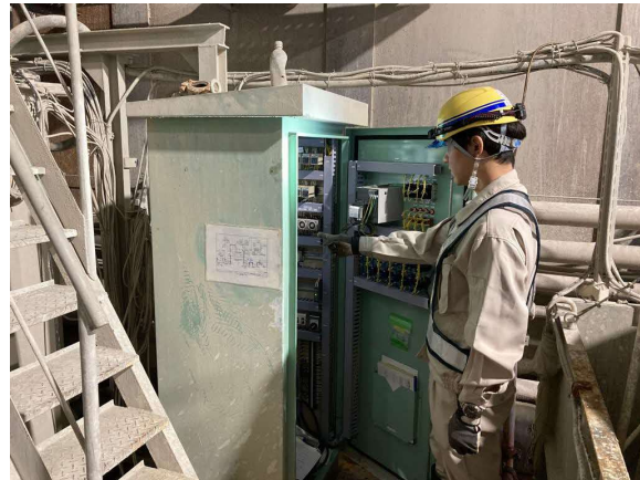
写真 7-1-1-10 処理設備の点検・整備による性能維持
