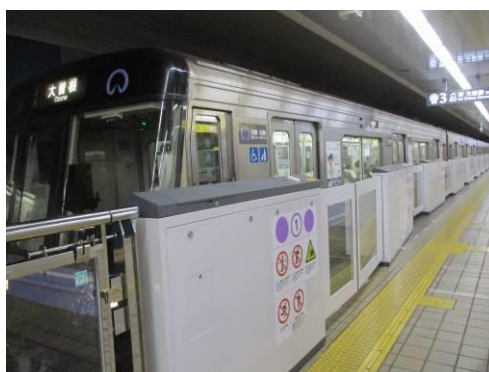
可動式ホーム柵の整備
