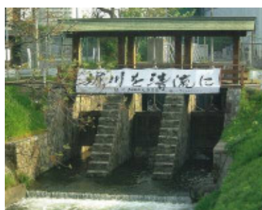
維持用水の確保 (庄内川からの導水)
