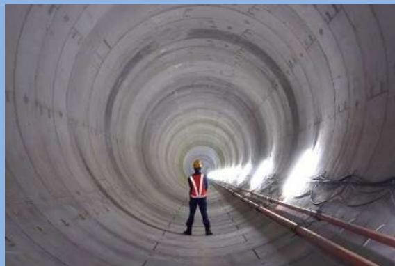
◆写真2 名古屋中央雨水調整池
