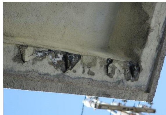
庇の一部が落下し、鉄筋がさびています。
