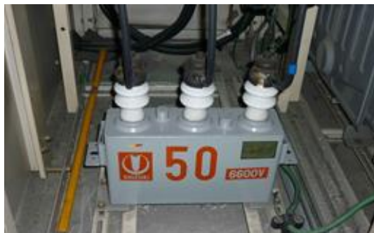
耐用年数を超過し、劣化が進んだ高圧コンデンサです。
