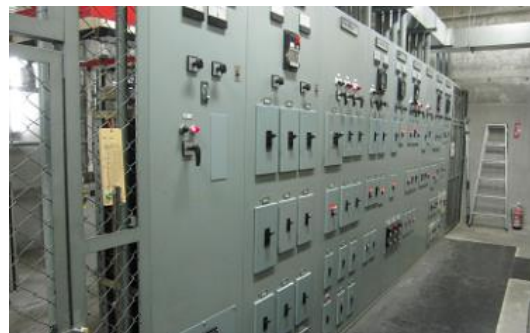
耐用年数を超過し、劣化が進んだ受電盤・配電盤です。
