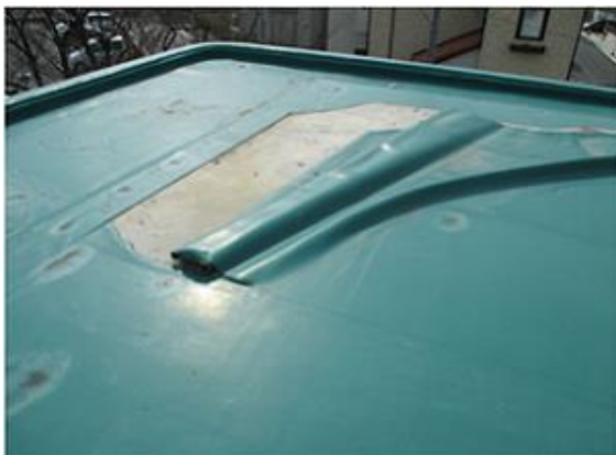
シート状の防水層が剥離し、めくれ上がってしまった状態です。
