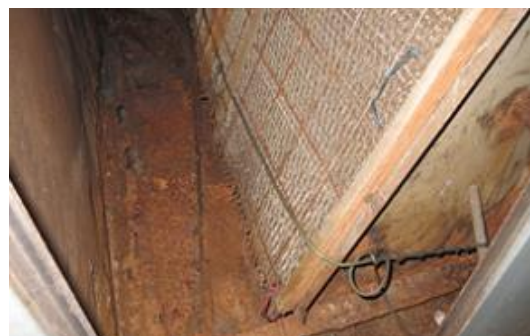
腐食が進んだ空気調和機の内部です。
