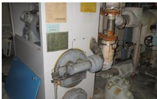
劣化が進んだ空調熱源機器です。
