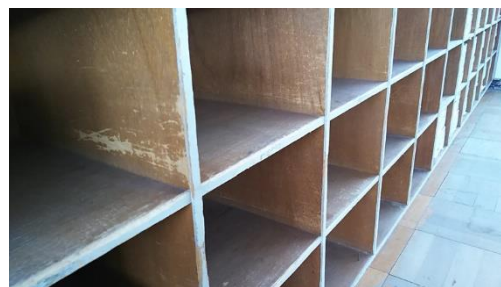
【図 2-2】老朽化した教室のロッカー
