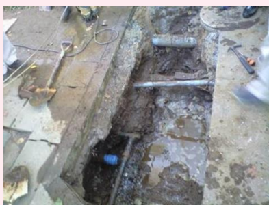
屋外の消火管の破裂 消火栓が使用できなくなります。
