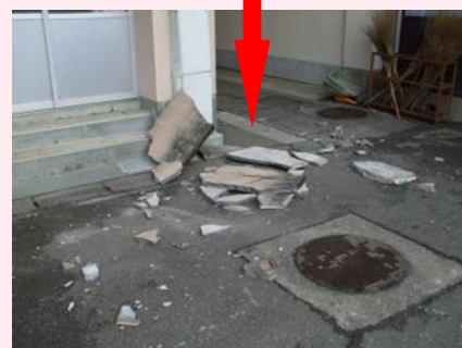
外壁のモルタル片が落下(築35年)
