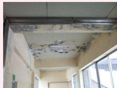
雨漏りにより天井が劣化(築38年) 【写真提供: 文部科学省】
