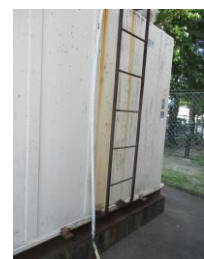
【図 2-12】老朽化した受水槽
