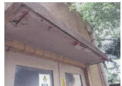
【図 2-10】鉄筋が露出した外壁
