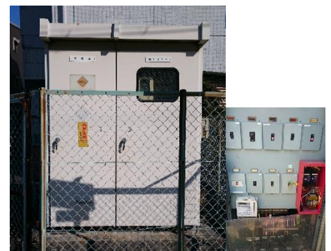
【図 2-11】古くなった受変電設備(内部)
