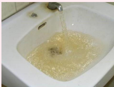
職員トイレの手洗から赤水発生 古い配管のサビが原因です。
