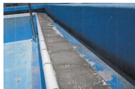
【図 2-8】老朽化したプール水槽
