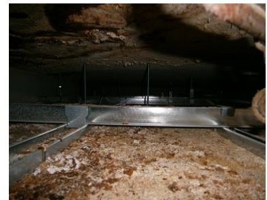
【図 2-9】雨漏りで浸食された天井裏
