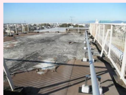
屋上の防水層が劣化(築38年)
