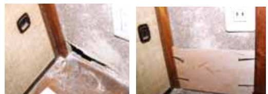
ベニヤ板で土壁の室内侵入穴を塞いだ例
