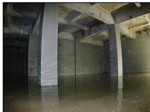
科学館の地下に設置された 雨水貯留槽の内部の様子
