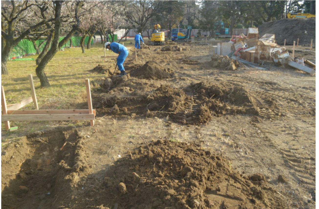
写真1 き損直後の現場状況／北から
