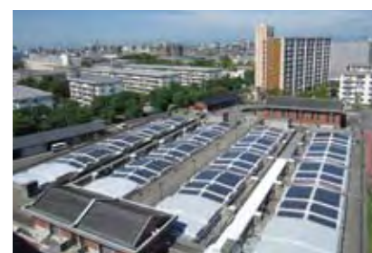
太陽光発電(鍋屋上野浄水場)
